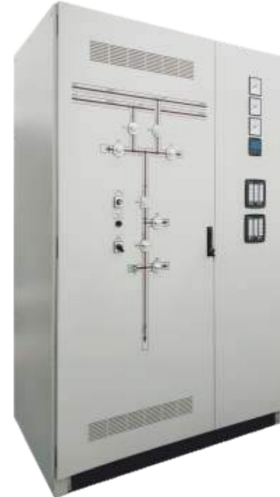
► 380 kV Lokal Kontrol Panel / Local Control Cubicle
