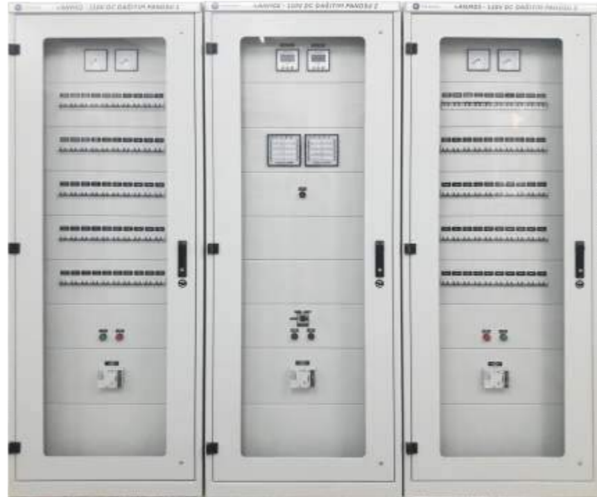
► 110 V AC Dağıtım Panosu / 110 V AC Distribution Panel
