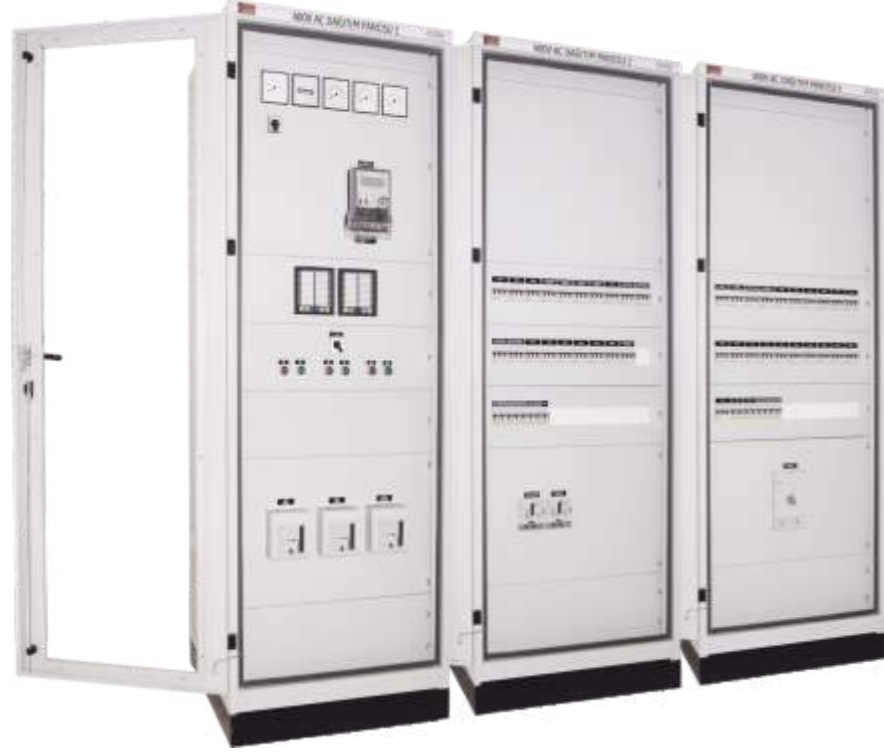
► 400 V AC Dağıtım Panosu / 400 V AC Distribution Panel
